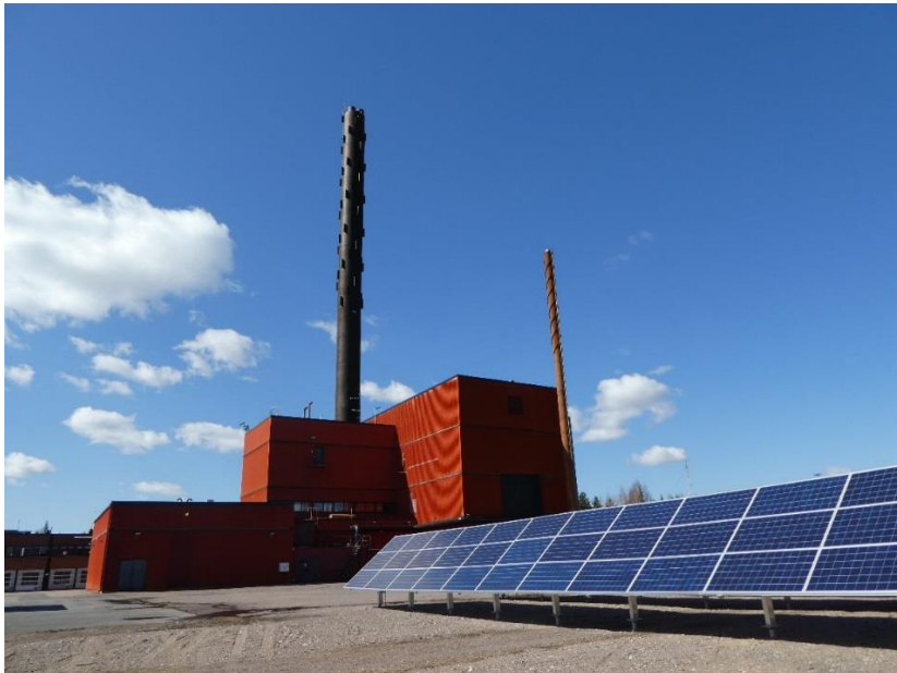
Aurinkovoimala, jolla tuotetaan sähköä Sahanmäen lämpökeskuksen pumppaamolle. Kuva: Hyvinkään Lämpövoima Oy
